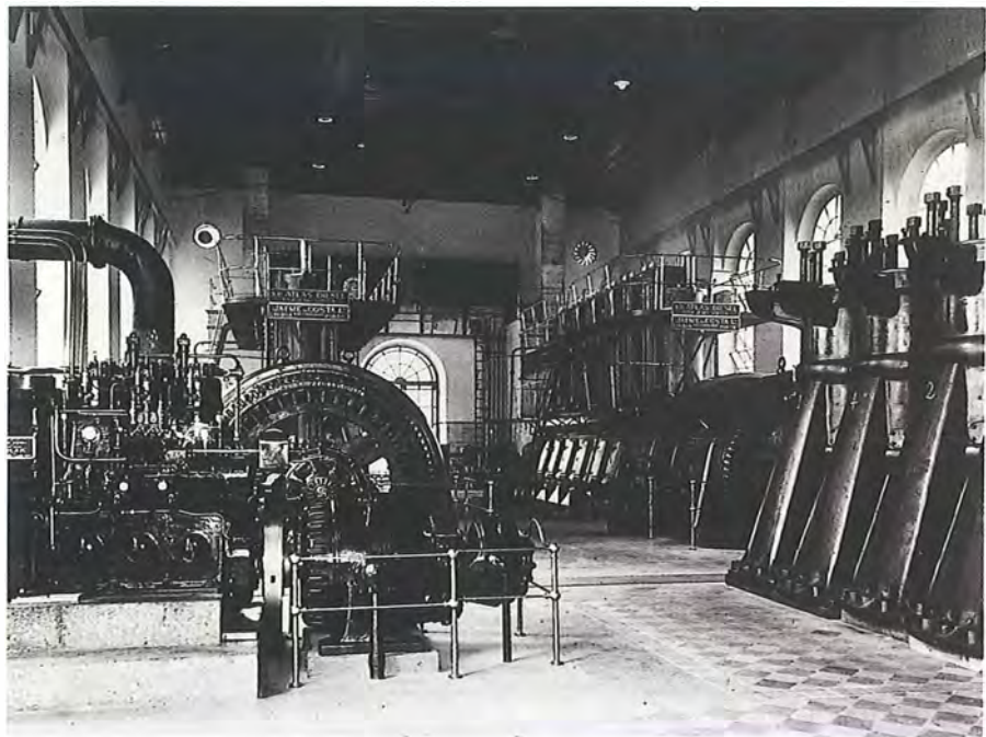
Casa das máquinas. Central eléctrica. Foto Mário Novais. Arquivo de Arte da Fundação Calouste Gulbenkian.
