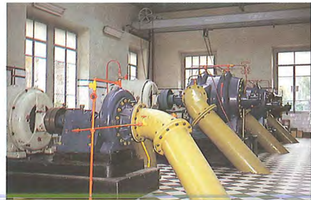
Barbadinhos II. Casa das Máquinas.
