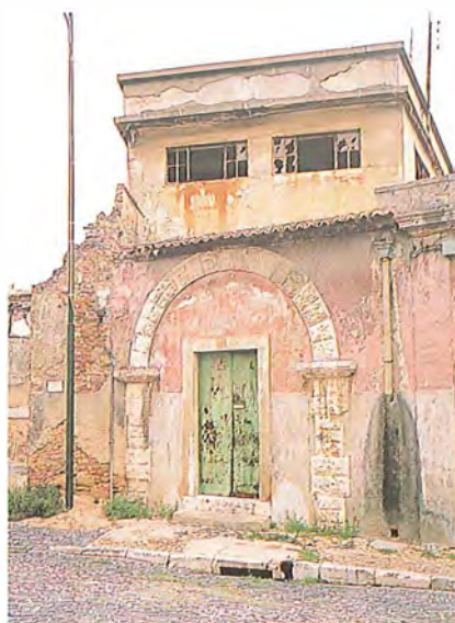
FACHADA EM RUÍNAS NA ESTRADA DE CHELAS
